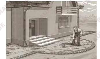
Подсыпка равномерно распределяется по поверхности несущего слоя и предварительно разравнивается с помощью подручного инструмента (например, граблей). Монтажный слой трамбуется (уплотняется) специальным электро- или бензоинструментом (виброплитой).
